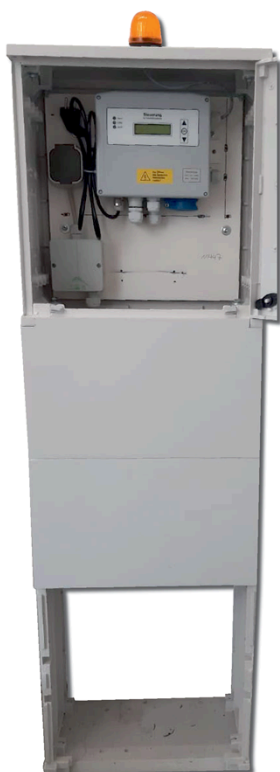
Steuergerät 230 V in Freiluftsäule bei Außenaufstellung
